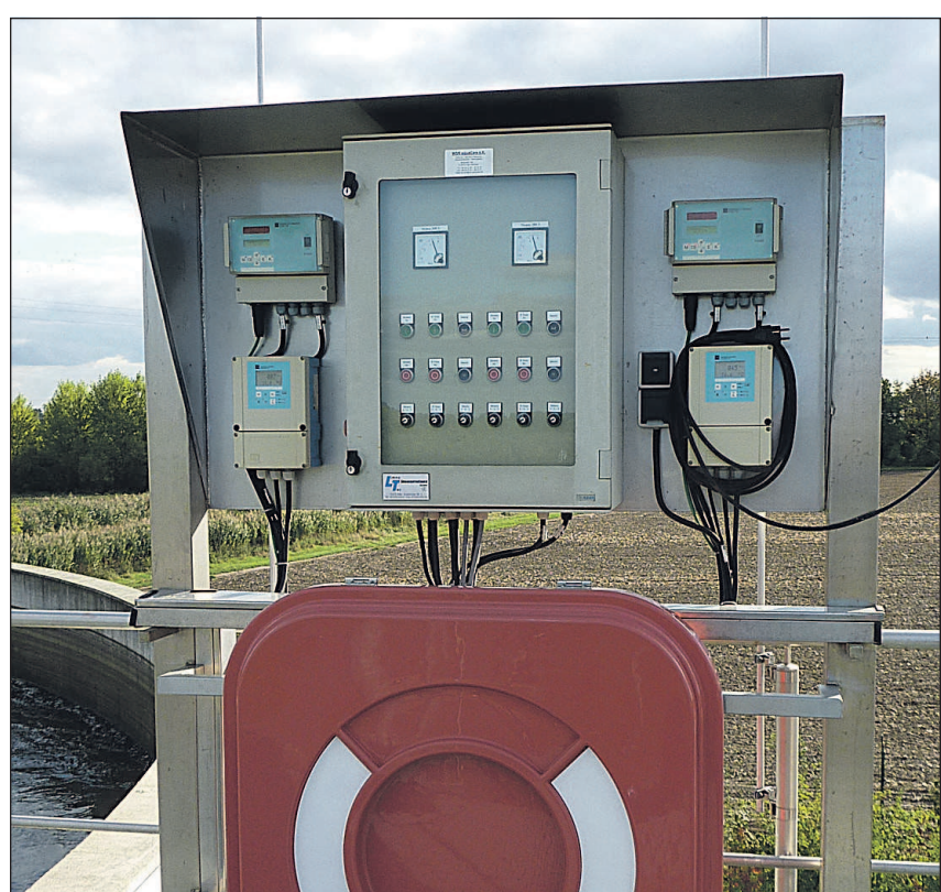
Volle Kontrolle: Messanlage des Klärwerks.
