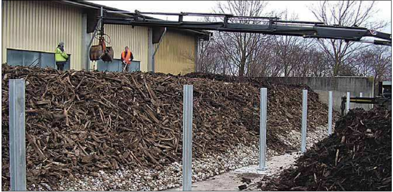
Durch das erneuerte Kompostfilter wird die im Biokompostwerk Grünstadt anfallende Abluft auswändig gereinigt.
