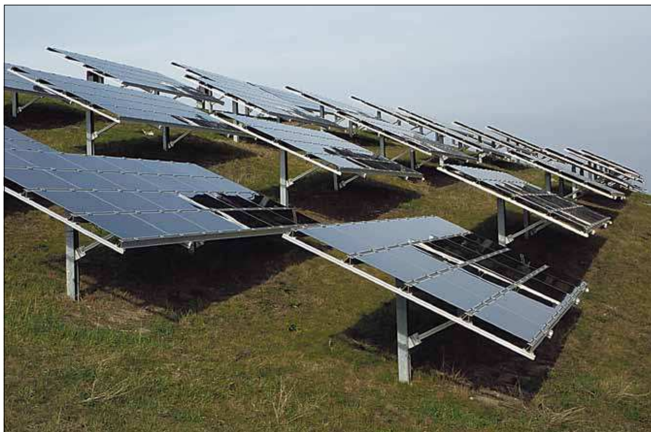
Ökologisch und wirtschaftlich: Die Photovoltaik-Anlagen haben 2009 auf der Deponie in Friedelsheim 106.000 Euro erwirtschaftet.
