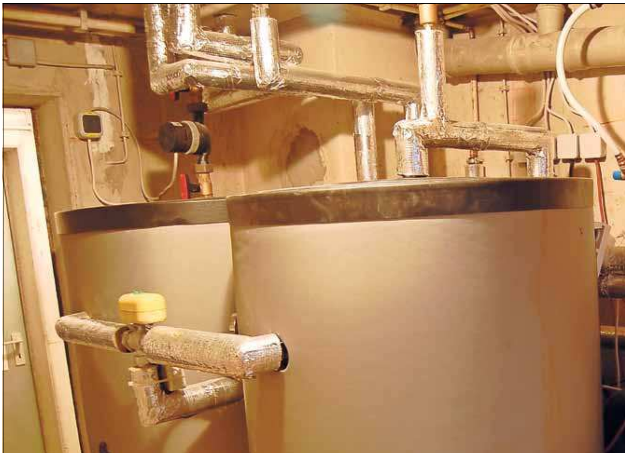
Gut verpackt: In diesen beiden Edelstahltanks wird das Wasser erwärmt.
