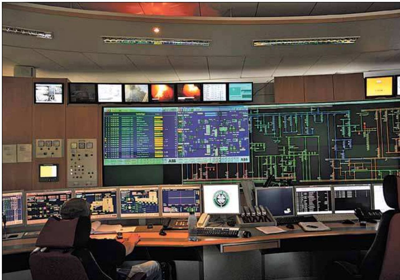
Schaltzentrale: Hier wird die Verfeuerung der Abfälle aus neun Gebietskörperschaften überwacht und gesteuert.
