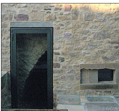
Neue Elemente mit sichtbarem Akzent: der Betonsturz markiert das Galeriefenster, das einen Blick aufs Gewölbe offenbart.
