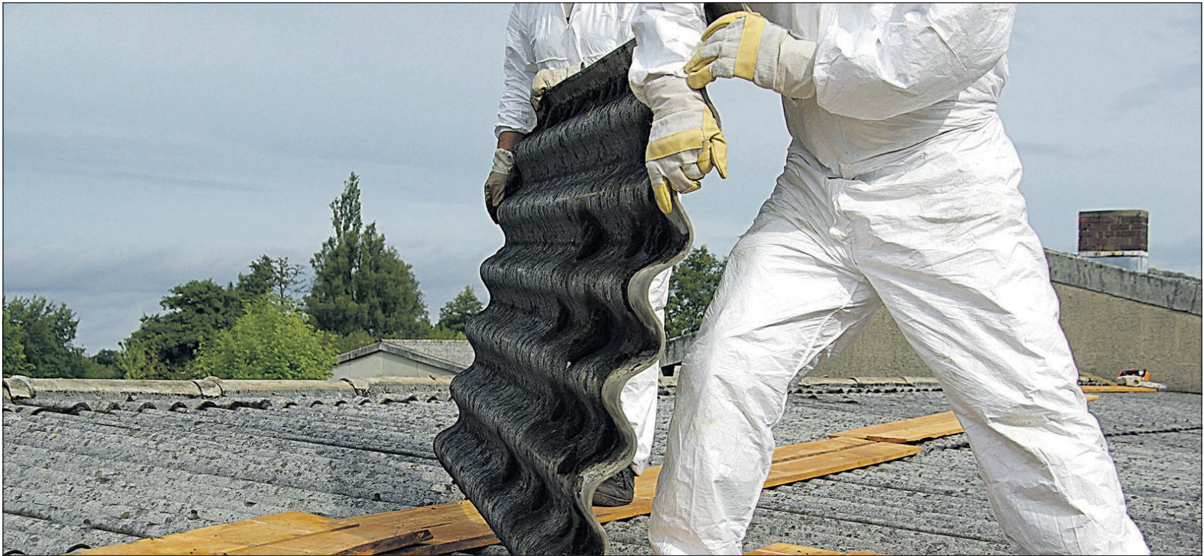
Vorsicht: Wer Baumaterial entsorgt, das Asbest enthält, muss besondere Auflagen erfüllen.
