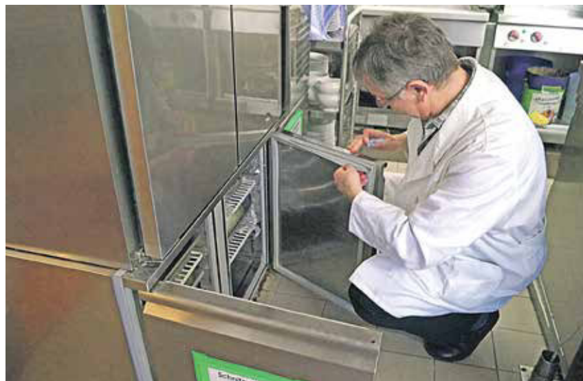
Vom Groben ins Detail: Erst schaut Robert Scheurer Boden und Wände an, dann kontrolliert er auch Dichtungen und Fettfilter. Foto: KV/Müller
