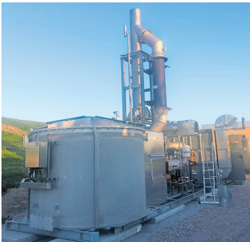
Spart Kosten in Millionenhöhe: Schwachgasbehandlungsanlage. Fotos: KV/König
