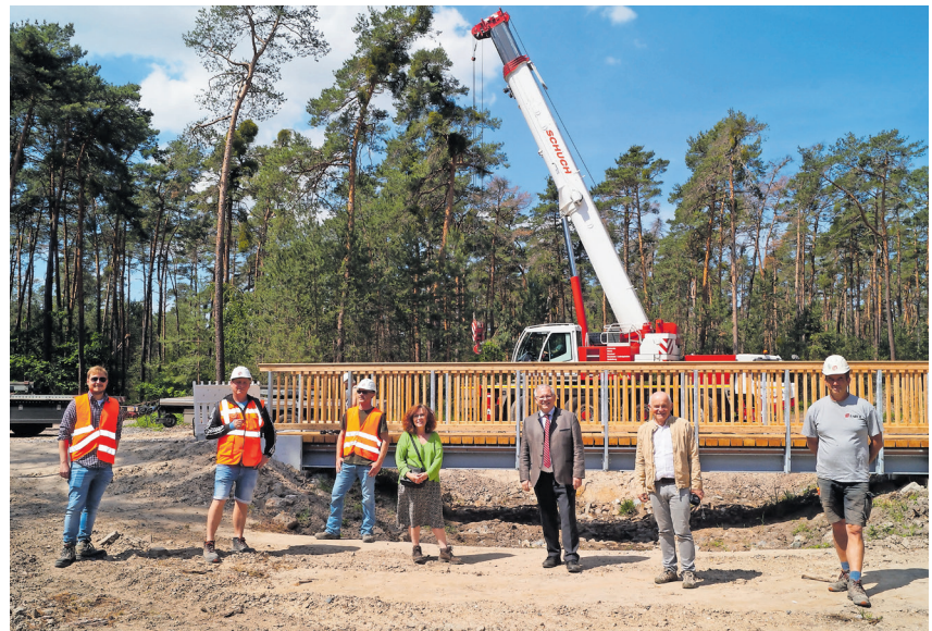
Freuen sich über den gelungenen Arbeitseinsatz mit schwerem Gerät: Landrat Ihlenfeld (3.v.re.) mit Büroleiterin Elke Thomas, Projektleiter Burkhardt Döll (2.v.re.), Felix Riedesel von BGS (li.) sowie Axel Schmitt, Kai Stuck und Ingo Häjssel von Faber Bau (restliche Personen, von rechts). Fotos: KV/Müller
