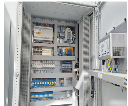
Die inneren Werte zählen: Schaltschrank von EWA.
