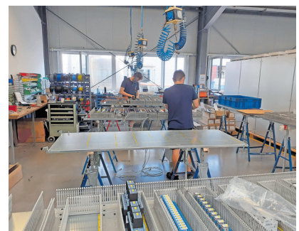
Konzentriert: Mitarbeiter bei EWA Elektrotechnik in Wachenheim.
