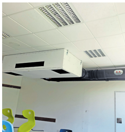
Das Werner-Heisenberg-Gymnasium hat eine neue Lüftungsanlage.
